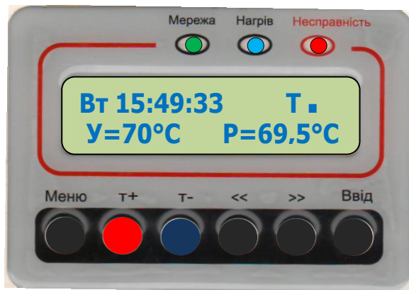
Рис. 25 Вид панелі управління електрокотла запрограмованого для роботи в межах тижня
